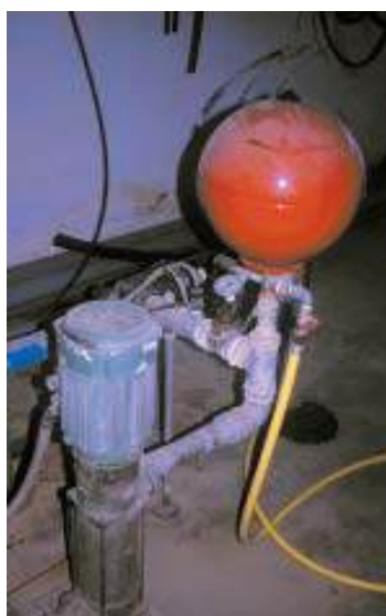
Figura 9. Equipo de bombeo con calderín.
