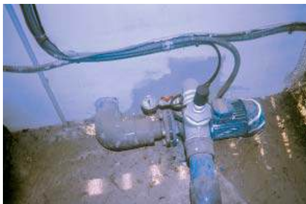
Figura 10. Bomba de eje horizontal.
