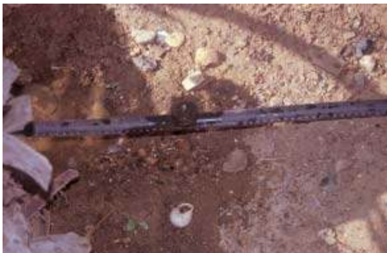
Figura 6. La colocación de los goteros en una posición correcta, previene de posibles obturaciones internas en los mismos.
